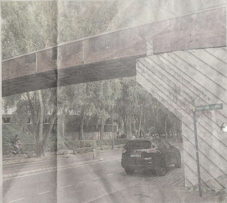
Endommagée par un incendie, la passerelle « Coltrane » a besoin d'être rénovée.
